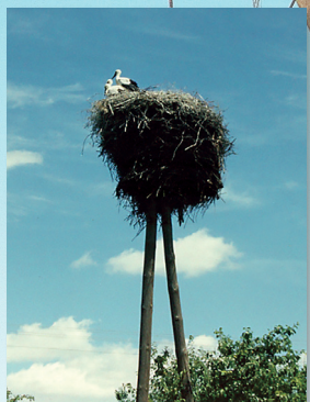
Podwójny drewniany słup energetyczny z dwutonowym, leciwym gniazdem rodem z lat osiemdziesiątych ubiegłego stulecia (PS/LTO)
